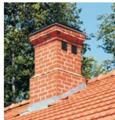
Udany przykład współczesnie wykonanego kominia
